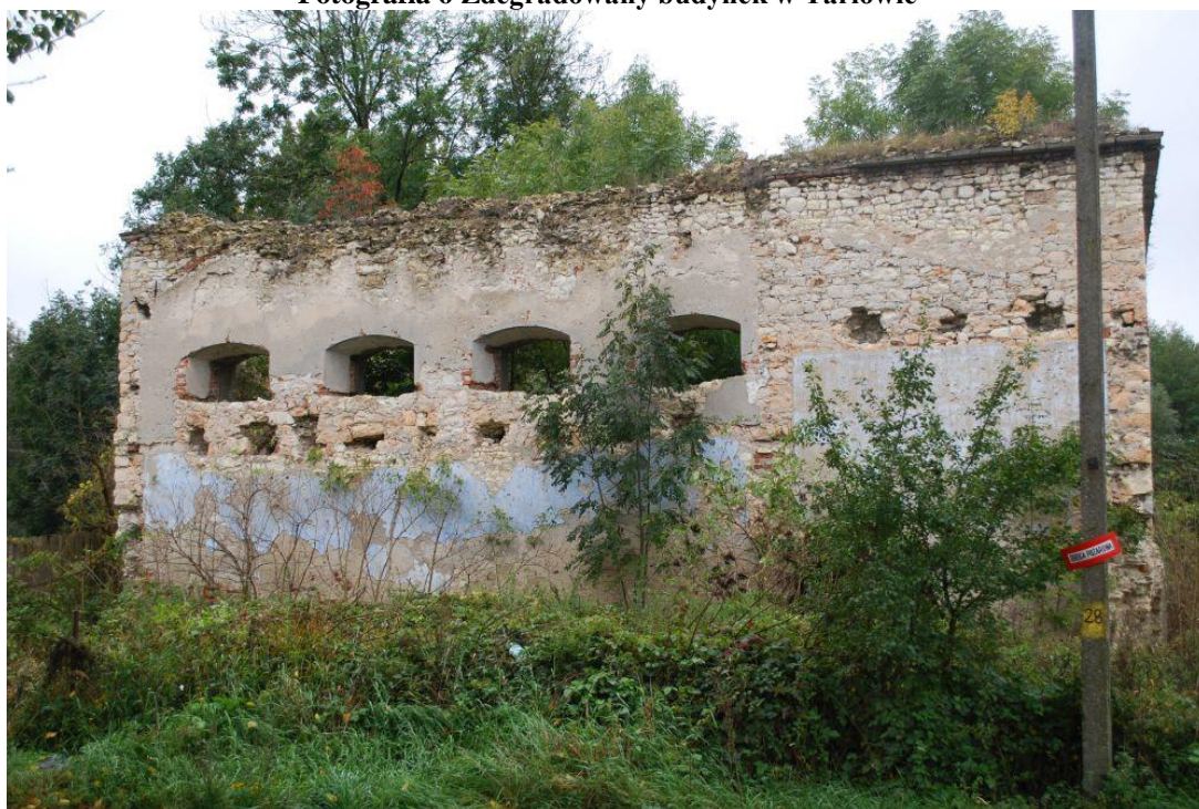
Fotografia 6 Zdegradowany budynek w Tarłowie
